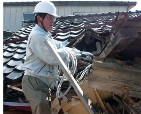
新潟中越沖地震倒壊家屋での検索試験
